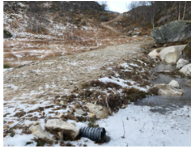
Denne ulovlig bygde landbruksvegen på Hamrabø i Suldal ble godkjent av Landbruksdirektoratet. Foto: Erik Thoring.
