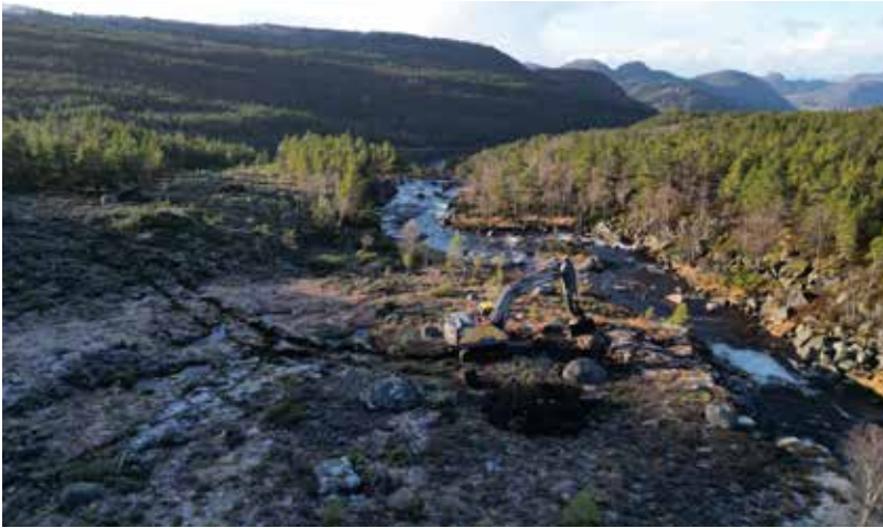
18.november: Skogen er flatehogd og en gravemaskin står klar ved damstedet i Øvre Ullestadåna. Foto: Arnfinn Nilsen/Miljøvernforbundet
